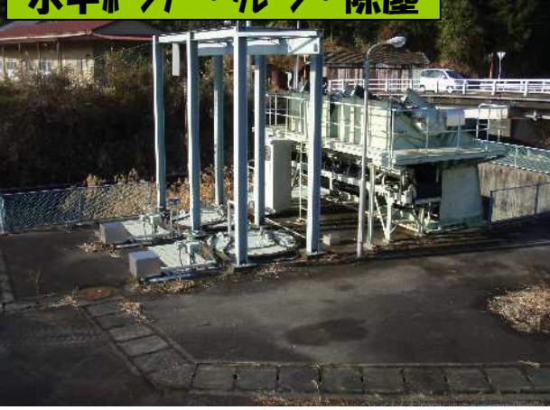
水中ポンプ・クレーン・除塵
