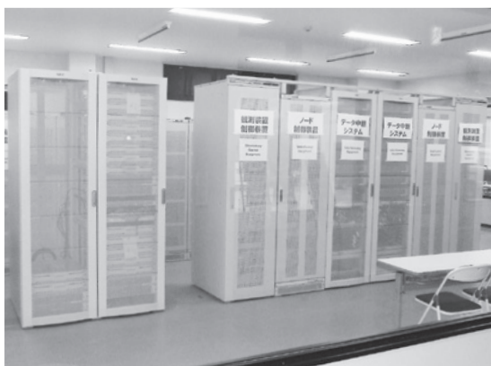
津波避難監視システム（三重県尾鷲市）
