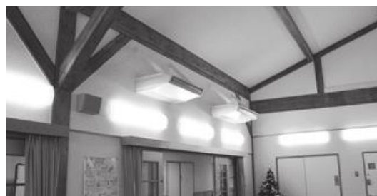
エアコンが設置されている海南幼稚園
