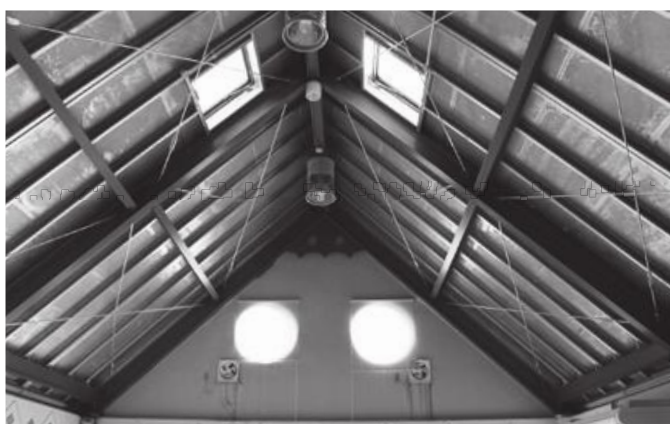
排煙窓・換気扇
