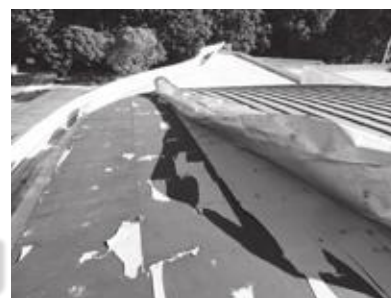
損傷したマリンジャムの屋根
