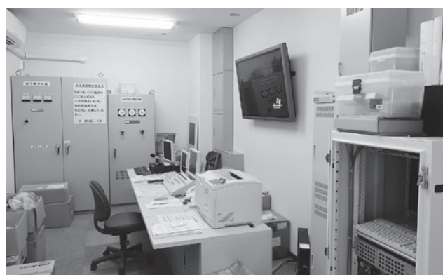
更新予定の防災行政無線放送器機
